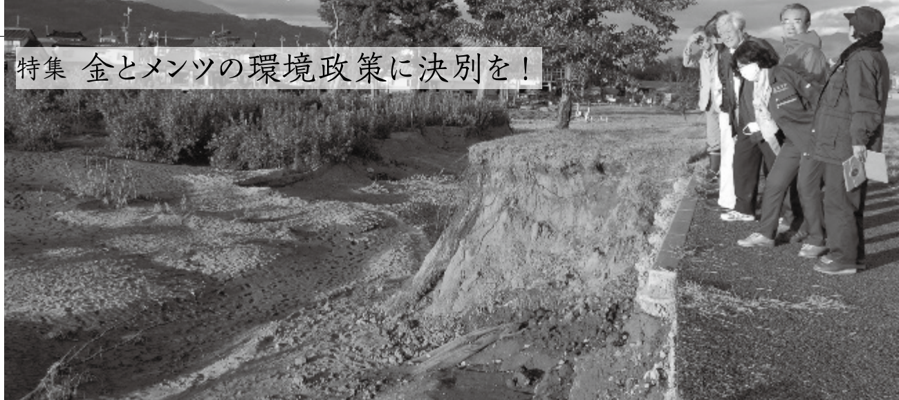
家屋を濁流が飲み込んだ決壊地点（新潟・長野県境から千曲川58km地点）での決壊幅は70mだが、間際の堤防も決壊寸前まで破壊され、堤防天板のアスファルトで持ちこたえていた。（2019年11月11日、筆者撮影）
